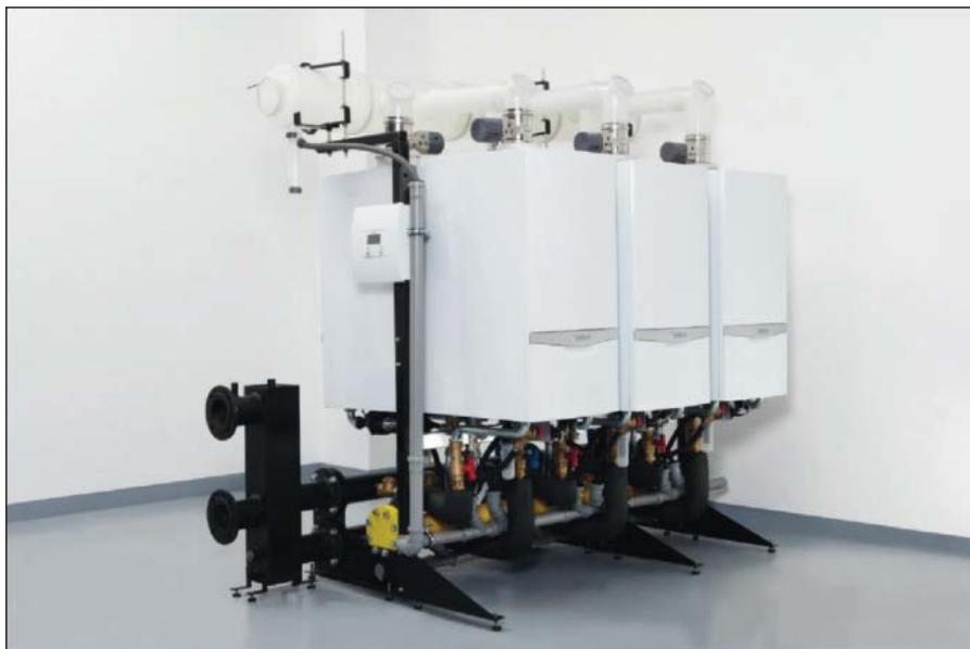
Рис 38: Каскад из шести агрегатов, установленных «спина к спине» (в примере установке не учитывается термоизоляция)
